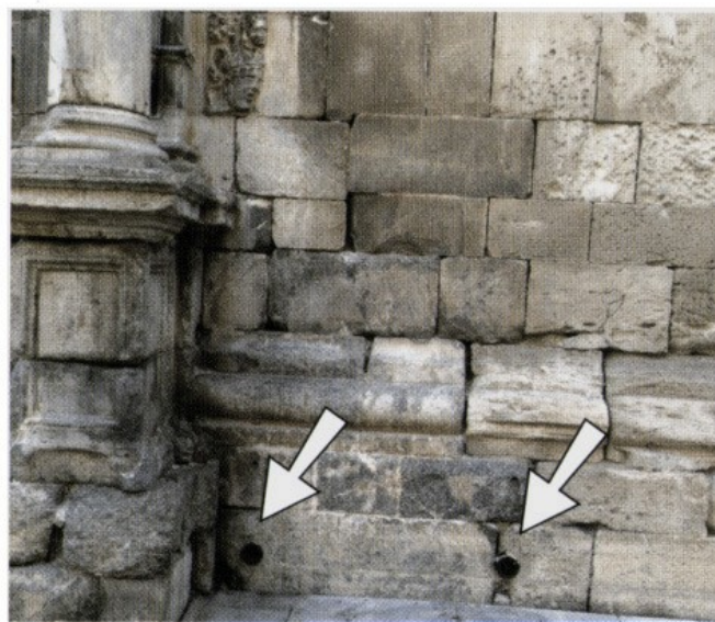
figura 42 - Para evitar este deterioro del edificio, los bloques más afectados fueron sustituidos y se montaron respiraderos (indicados con flechas) para interferir en el proceso del ascenso capilar de la humedad.
